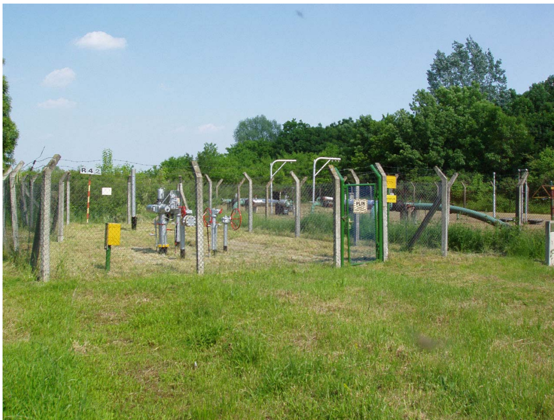
Plinska blok stanica i međučistačka stanica magistralnog naftovoda
